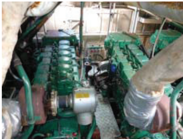
Motorrym i Tpbs 272 Foto Rådmansö Rederi
